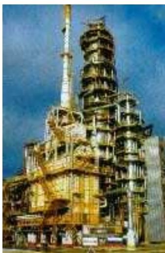
Рисунок 6 – Установка вакуумной перегонки мощностью 1,6 млн. тонн в год на НПЗ «ЛУКОЙЛ-ПНОС». На переднем плане – трубчатая печь (жёлтого цвета)
