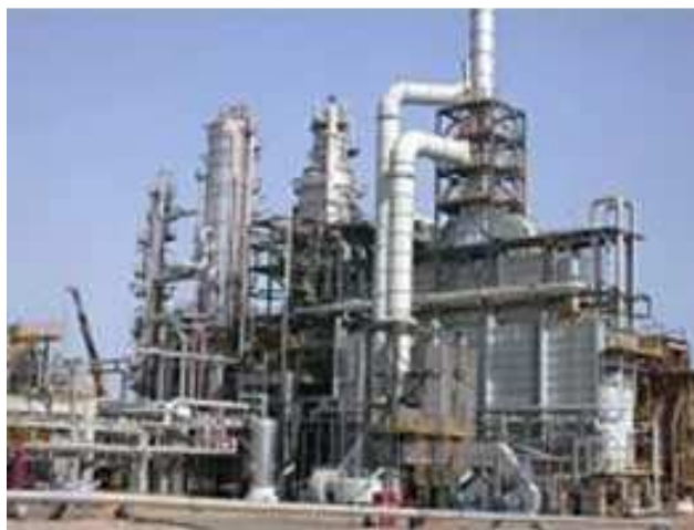
Рисунок 5 – Установка вакуумной перегонки мощностью 1,5 млн. тонн в год на Туркменбашинском НПЗ по проекту фирмы Uhde
