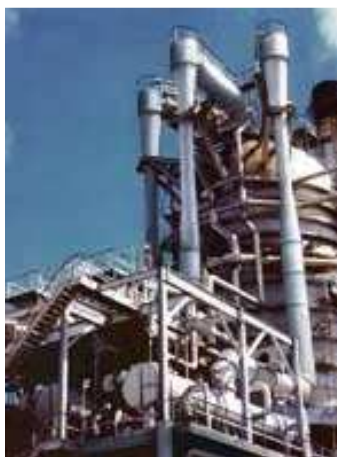
Рисунок 7 – Вакуумсоздающая аппаратура фирмы Graham. Видны три эжектора, в которые поступают пары с верха колонны
